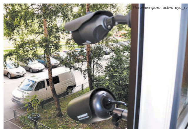
Видеонаблюдение позволяет контролировать автомобиль почти круглосуточно
